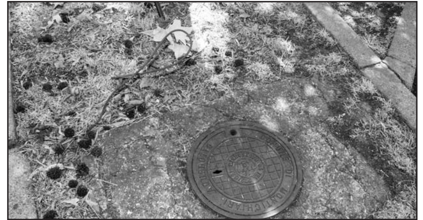
Il ferro, quasi invisibile, un pericolo.
